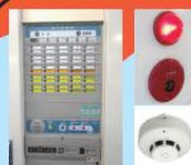
自動火災報知設備
