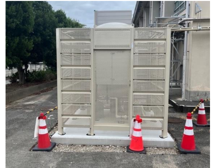
屋内運動場の空調は災害時も利用可能 なLPガス空調で整備 (稲沢市立稲沢西中学校のLPガスバルク)
