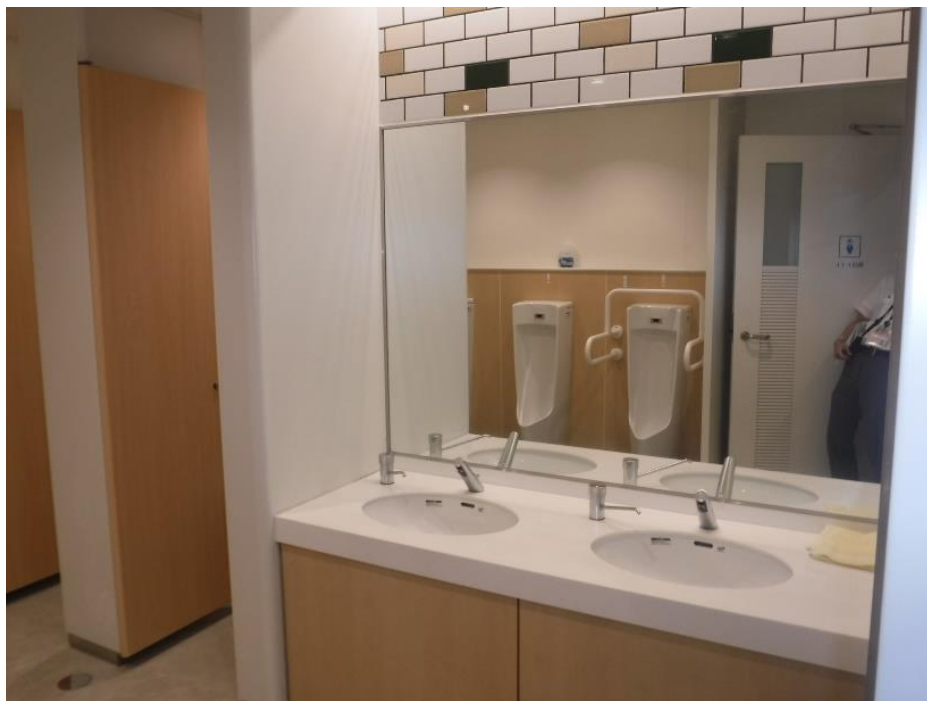
非接触化された手洗い設備
