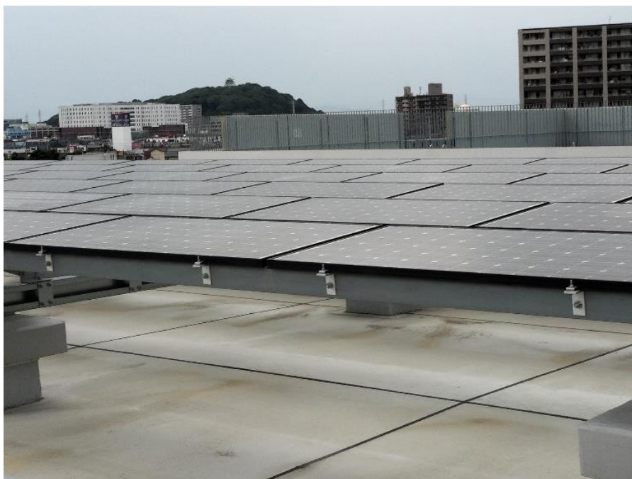
屋上に設置された太陽光発電設備
