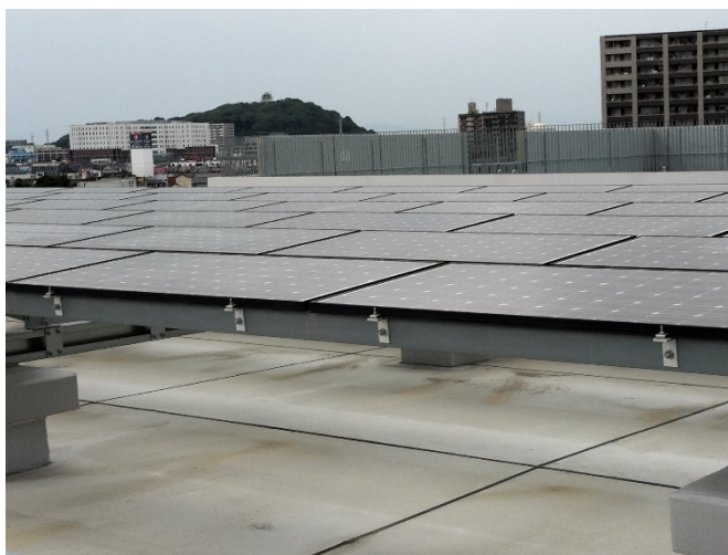
（屋上に設置された太陽光発電設備）【小牧市立小牧南小学校】
