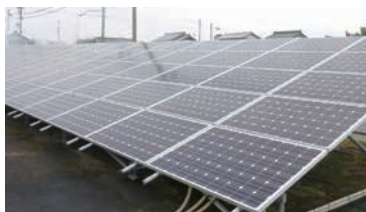
太陽光発電設備
