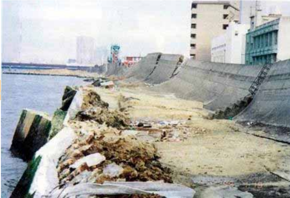
【1995年阪神淡路大震災】淀川河川堤防
