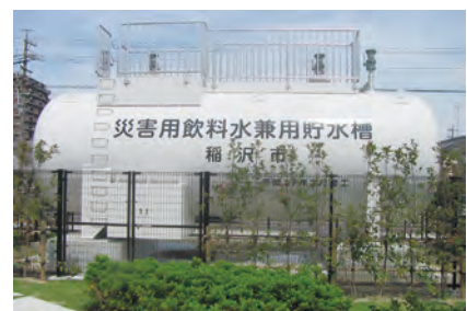
耐震性貯水槽
