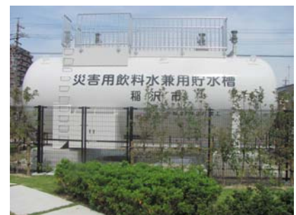
耐震性貯水槽
