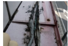
周辺機器（**）の劣化、破損 ※分電盤、配線、変圧器（トランス）、スイッチ等
