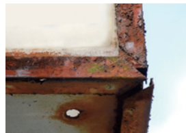
側板、表示面板押さえの腐食、 破損、ねじれ、変形、欠損
