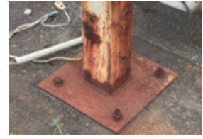
鉄骨のさび・ 塗装の老朽化
