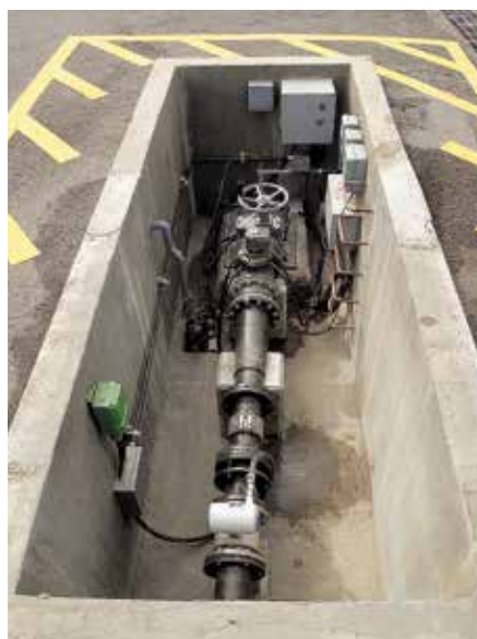
石橋浄水場内の井戸の取水ポンプ
