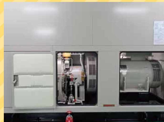
自家発電機設備
