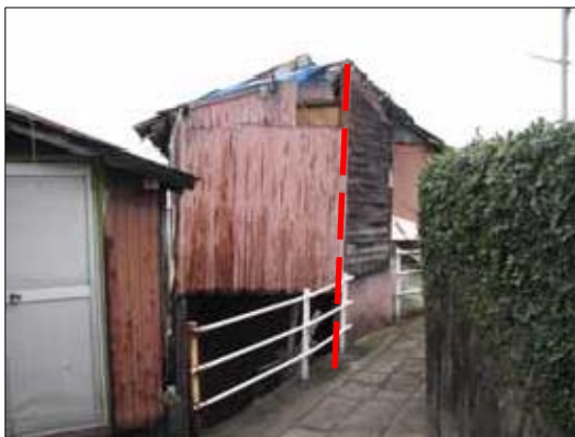
一部の柱が傾斜している例
