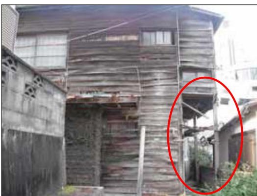
柱の数箇所に破損がある例
