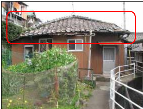
屋根に不陸がある例
